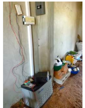
教員住宅内に設置されているソーラーバッテリー▲
